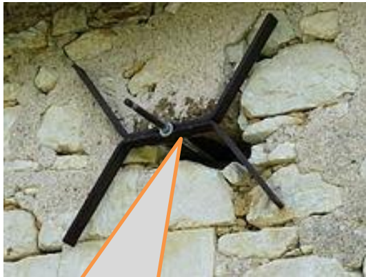
Ancre en X apparente reliée au tirant traversant les maçonneries
