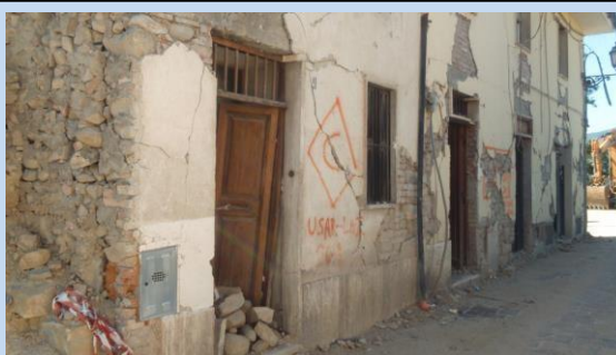
Fissuration d'origine mécanique, séisme, sur trumeaux de maçonnerie (Amatrice-2016)
