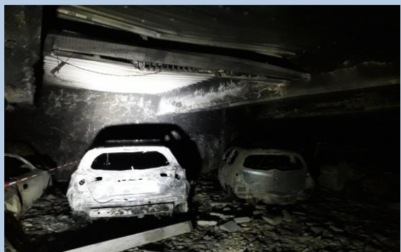
Fissuration d'origine thermique sur poutre BA (SDIS33-2019)
